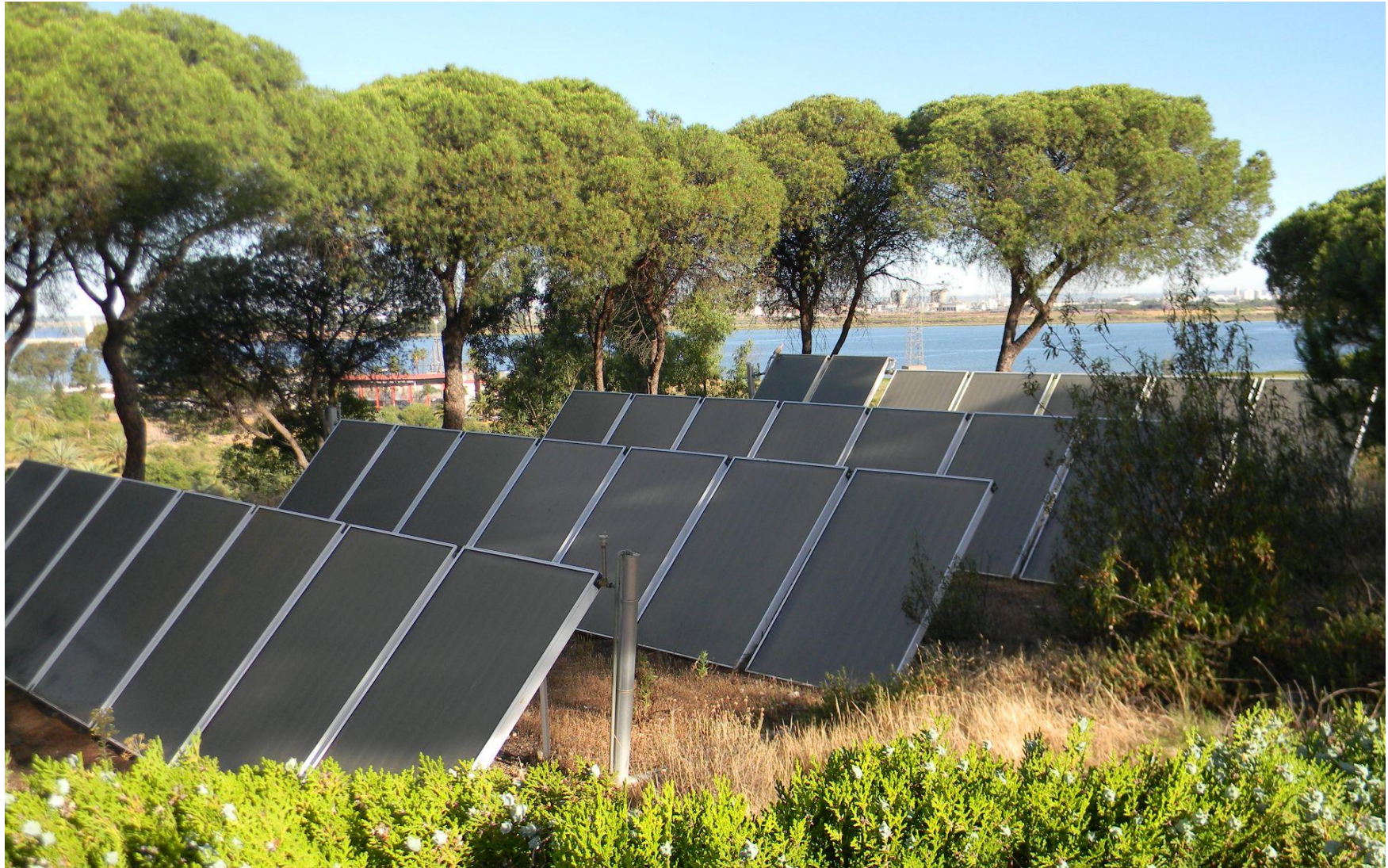
Imagen de la instalación de energía solar térmica en la sede de La Rábida. Fuente: Sostenibilidad a Medida
